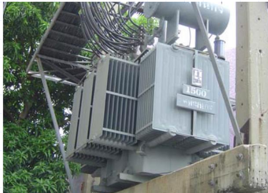
หม้อแปลงที่ปรับลดแรงดันด้านทุติยภูมิ
