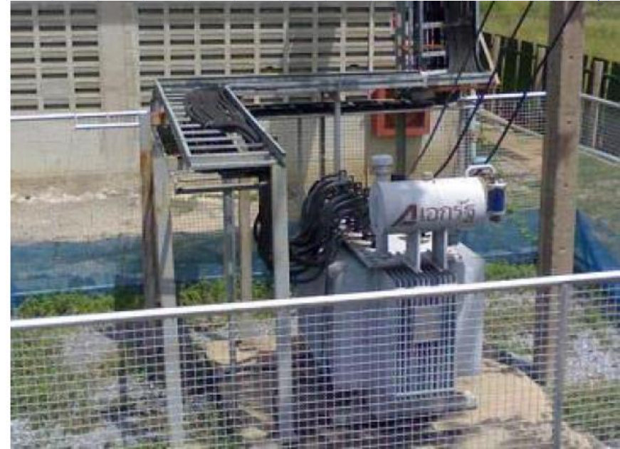
หม้อแปลง TR5 แปลงไฟฟ้า 22 kV เป็น 400 V จ่ายไฟฟ้าให้กับอาคาร 3, 4
