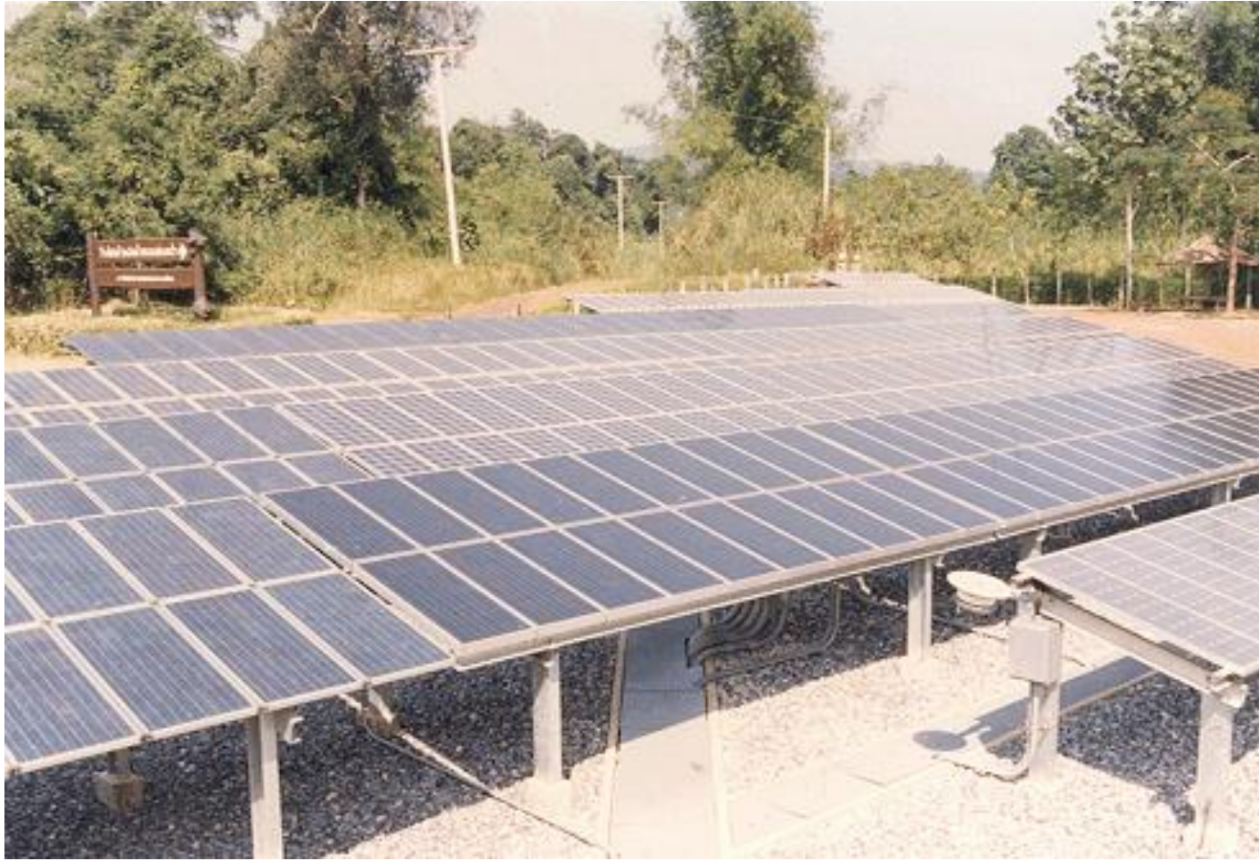
ภาพแสดงแผงเซลล์แสงอาทิตย์สถานีพลังงานแสงอาทิตย์คลองช่องกล้า จังหวัดสระแก้ว
