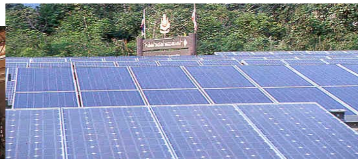
โรงไฟฟ้าพลังงานทดแทน
